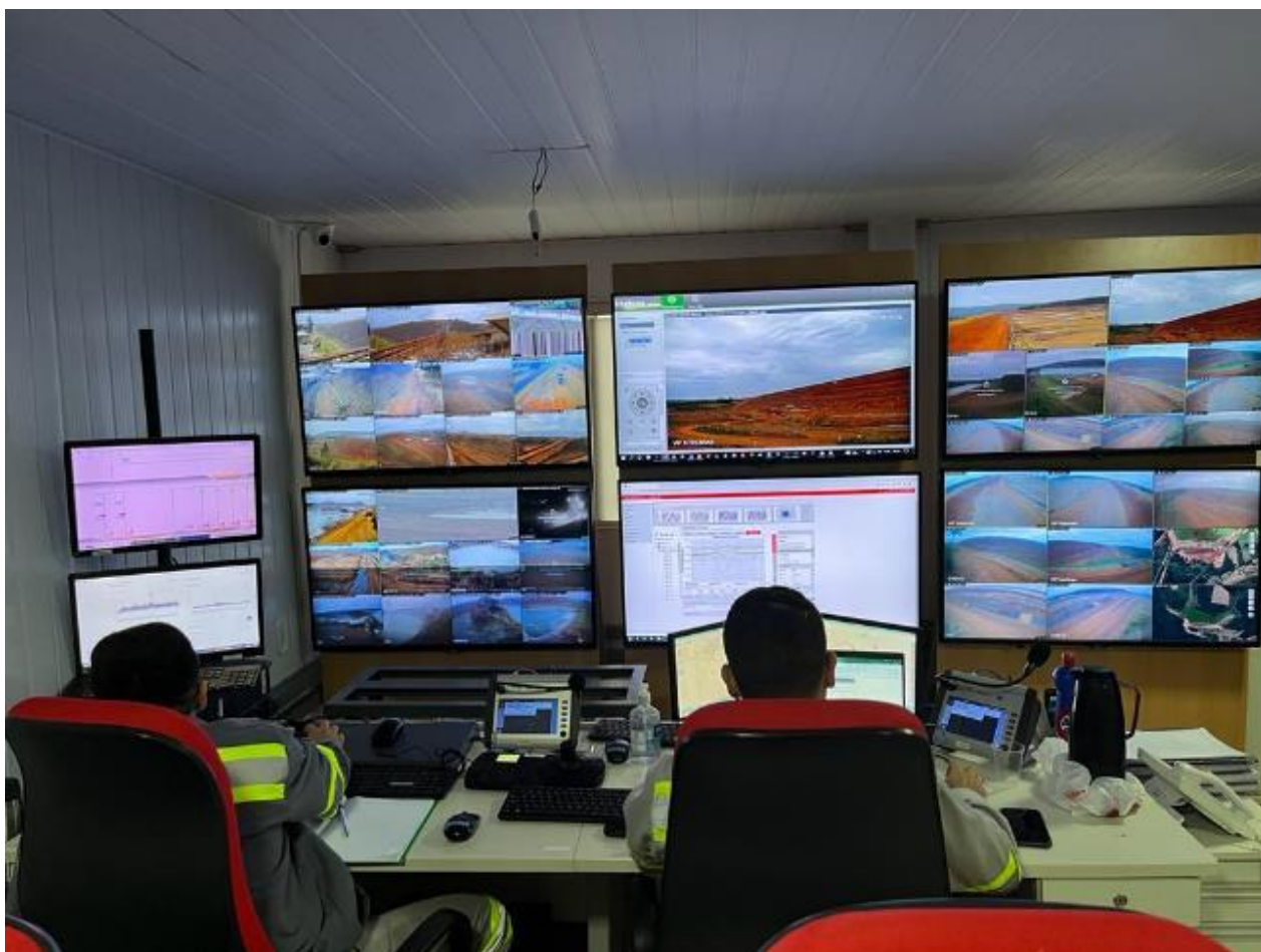
Figura 7.1 – Sala de Controle e Monitoramento de Barragens CMOC.
